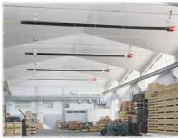
Рис. 11 Система отопления PANRAD: цех металлоконструкций
