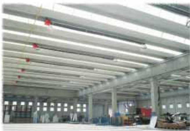
Рис. 10 Система отопления PANRAD: цех производства холодильных установок
